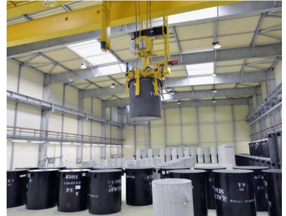
Installation CEDRA (Conditionnement et Entreposage de Déchets RAdioactifs), CEA/Cadarache.
