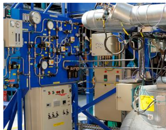
© P-F. Grosjean/CEA – Plateforme Papyrus, CEA Cadarache – Vue du circuit sodium
